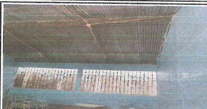
Foto 2: Deterioro de yoyis , sustitución por costaneras de metal en aulas .
