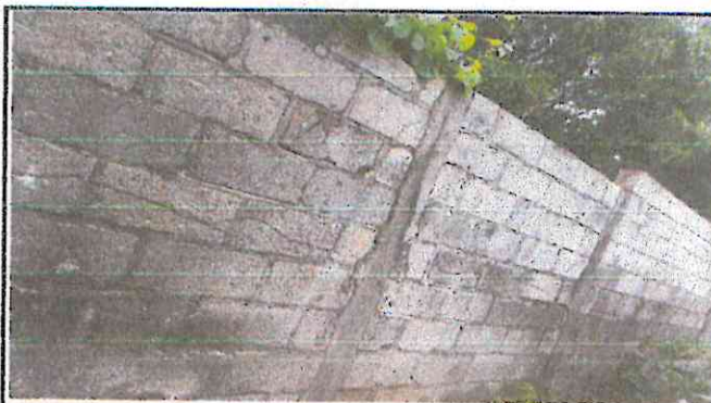
Foto 4: muro perimetral en mal estado reforsamiento con blok soleras intermedio y columna .
